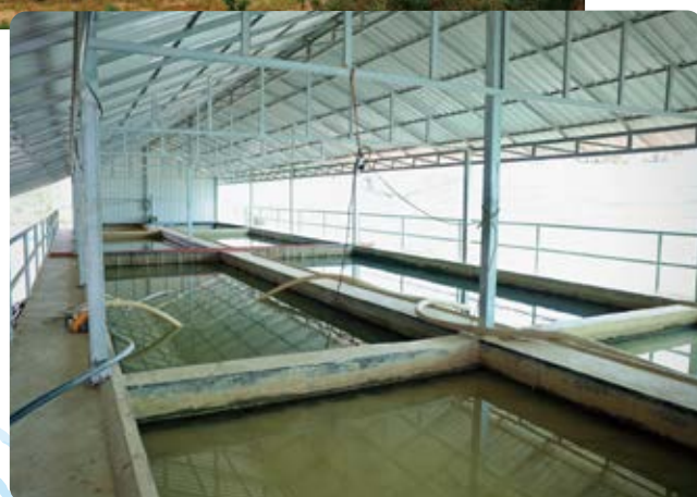
貯水池から機械でくみ上げられた水は浄水場へ流れ、浄水処理されたうえで、水道管を通じて各家庭に送られます。
