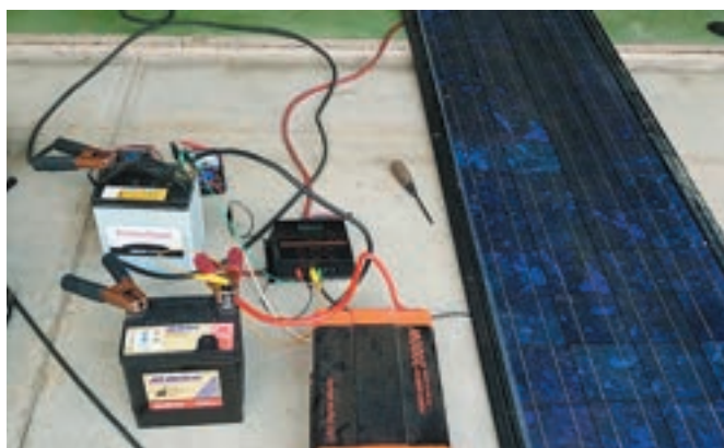
自作の太陽光発電設備で、オールクリーンなエネルギーの目標に向かう。
